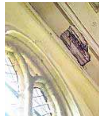
Der Putz bröckelt überall ab.
